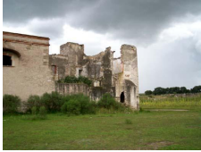
29 de 64 Casa principal Inmueble Casa principal I-0012107805, Conjunto Arquitectónico Puebla, San José Chiapa, San José Chiapa Camino s Cuapiaxtla Siglo XVII
